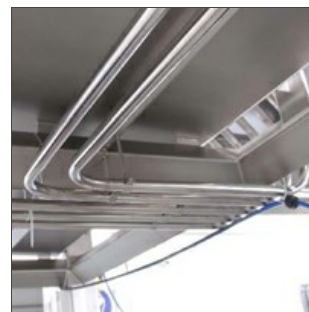
Particulier protection avec tuyauteries en acier pour câbles électriques
